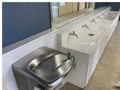
手洗い場（蹴込みがなく、 車いすでは使用できない）
