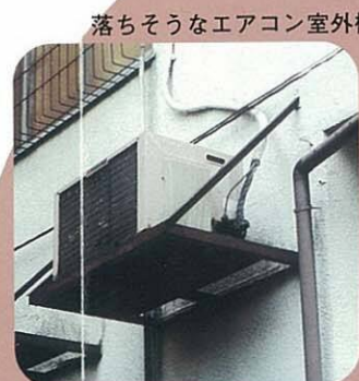
落ちそうなエアコン室外機
