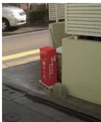
街路設置消火器
