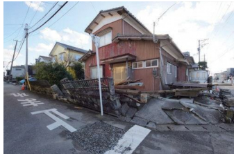
液状化の被害があった新潟県新潟市西区の住宅。（写真：建物修復支援ネットワーク）
