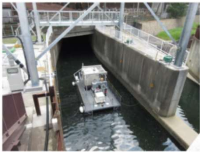
装置稼働状況
