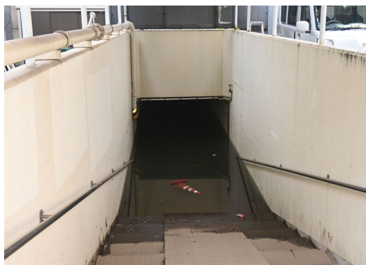
令和6年7月 地下道冠水(岸町)
